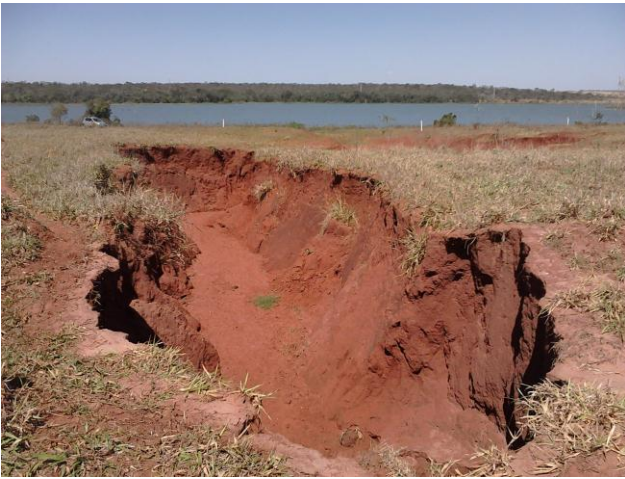
Foto 43 – Ponto de erosão P04.
