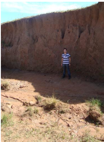
Foto 29 – Ponto de erosão P02.
