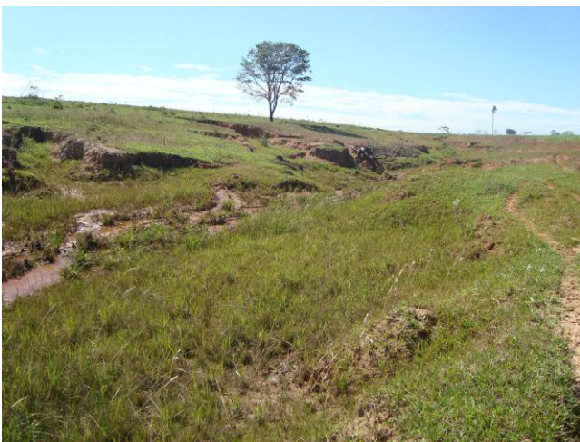
Foto 3 – Ponto de erosão P01.
