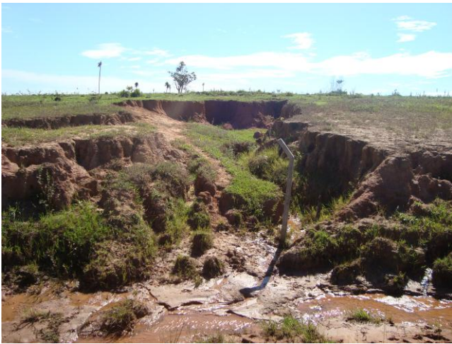
Foto 7 – Ponto de erosão P01.
