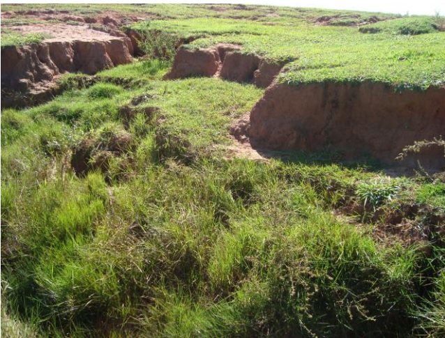
Foto 15 – Ponto de erosão P01.
