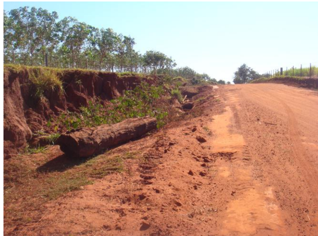
Foto 52 – Ponto de erosão P07.
