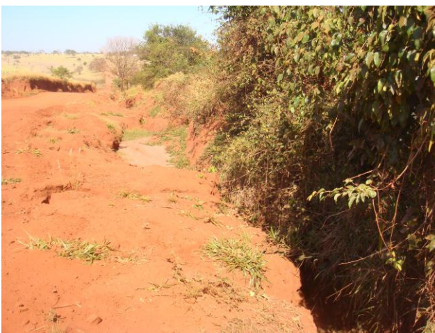
Foto 53 – Ponto de erosão P07.
