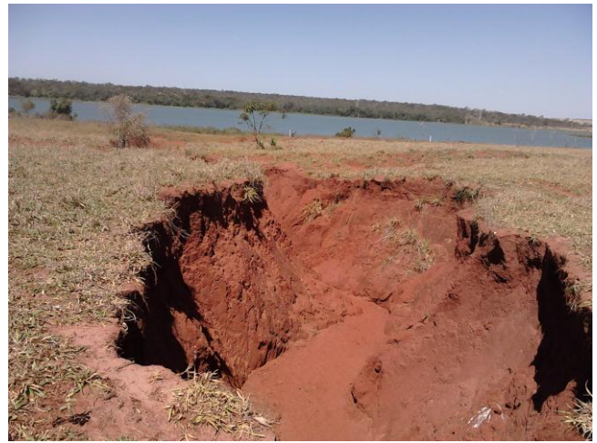
Foto 44 – Ponto de erosão P04.
