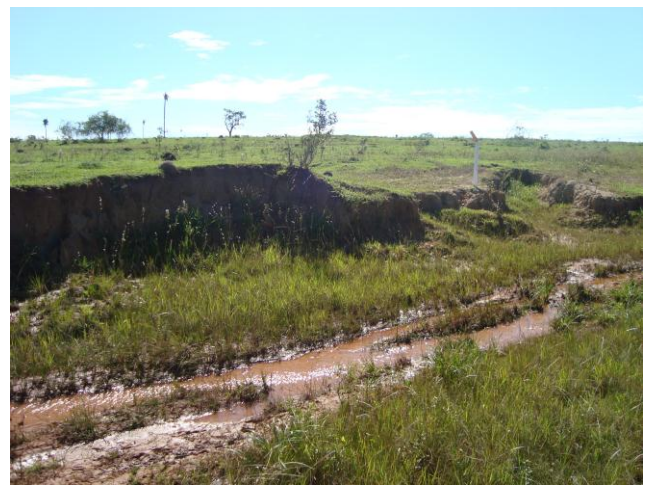
Foto 2 – Ponto de erosão P01.
