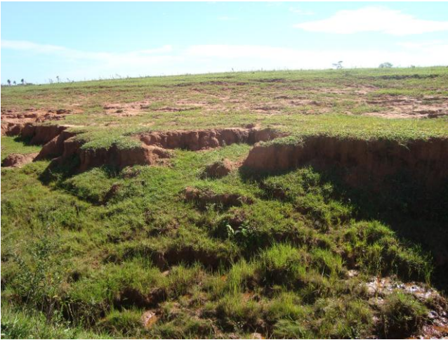
Foto 13 – Ponto de erosão P01.
