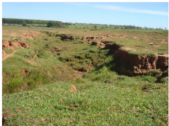
Foto 16 – Ponto de erosão P01.
