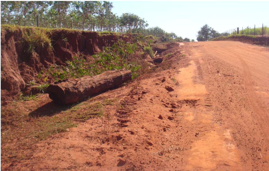
Figura 7.5 – Lateral de estrada funcionando como canal escoadouro com arraste intenso de partículas.
