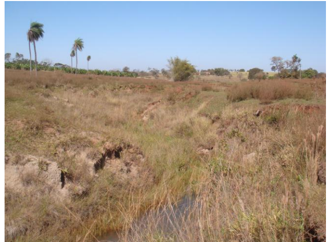
Foto 62 – Ponto de erosão P10.
